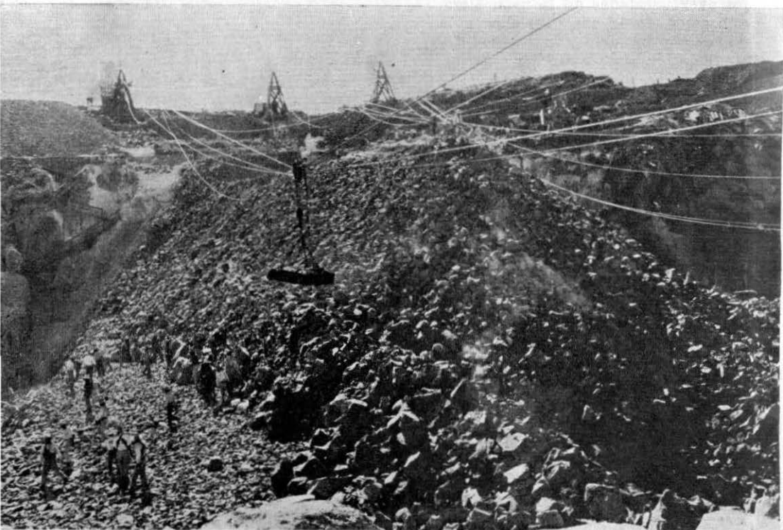
Cable-vía utilizado en la construcción de la presa "Madero", de Huichápan, Hgo.
