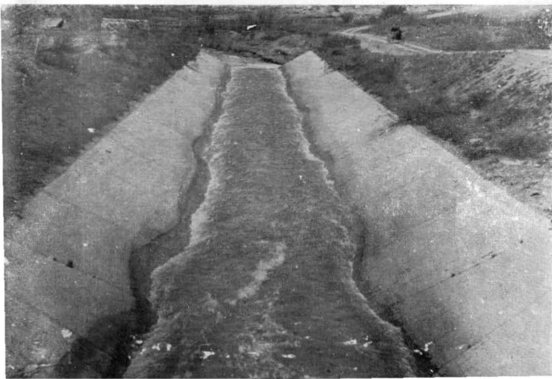
Rápida de la Planta Hidroeléctrica de Salinillas.
