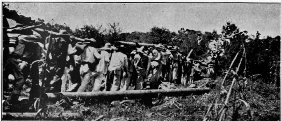
Caravana de transporte de tuberías, por la línea troncal de Milpa Alta.
